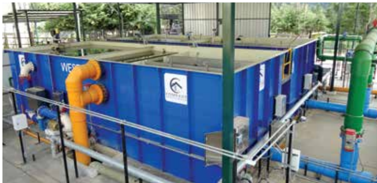
Modular treatment plants - DWTP El Milagro
